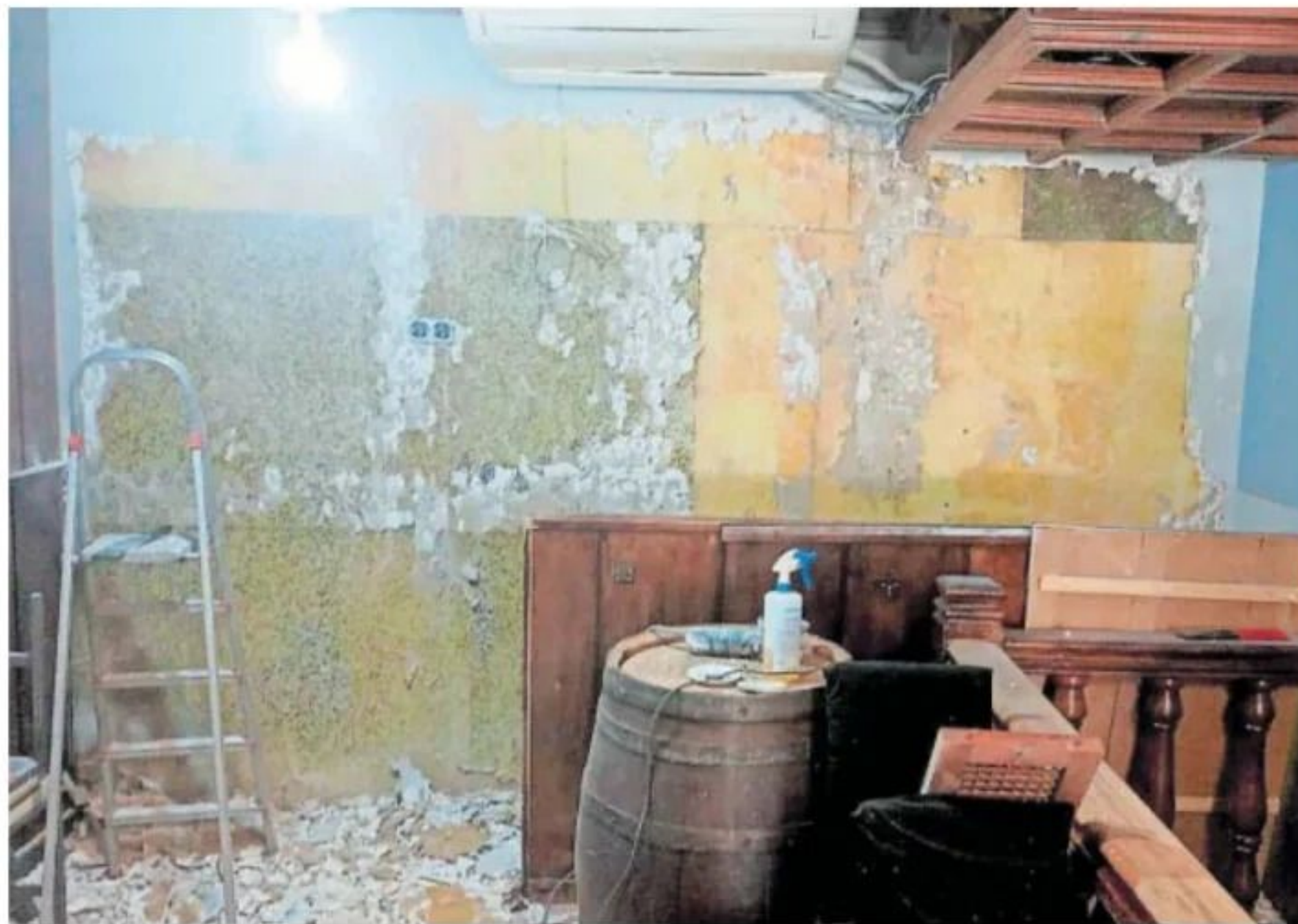
Algunos de los daños causados por la inundación de aguas fecales.
